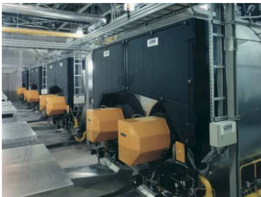
четыре двухжаротрубных газотрубных котла UNIVERSAL ZFR с паропроизводительностью 120 т/ч на бумажной фабрике
